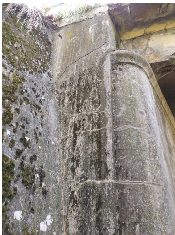
Fig. 3.4 – Lesione lungo la spalla Corsia Ovest lato Casalgrande
