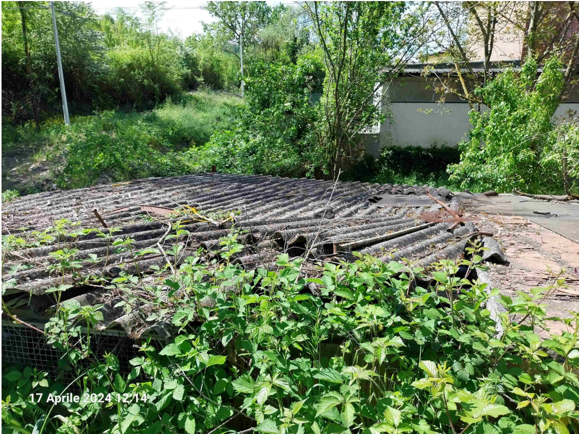
lastre in cemento-amianto appoggiate sul tetto dell'adiacente baracca privata (mappale 134-135)
